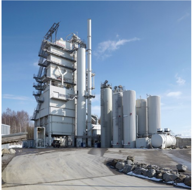
Asphalpmischanlage in Grenis. Sie wird mit Braunkohlestaub betrieben.
