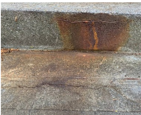
Stahlbeton mit Rissen und Abplatzungen.
